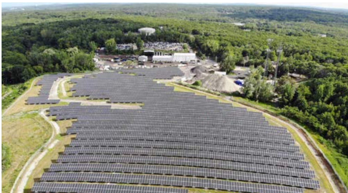
Nous avons investi dans le réseau solaire de 2,6 MW situé à North Providence, au Rhode Island, qui a été érigé sur un ancien site d'enfouissement.
